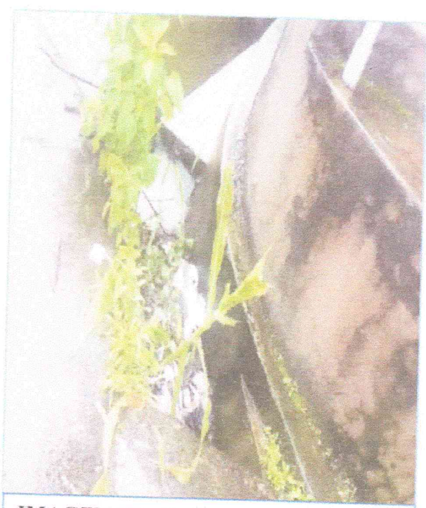
IMAGEN N° 02: Cunetas obstruidas por presencia de residuos sólidos
